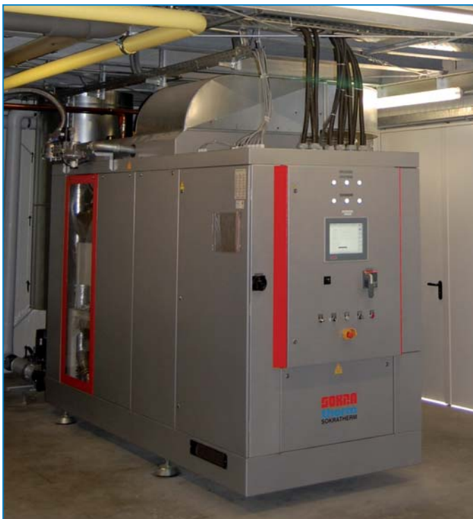
Abb. 2: BHKW-Kompaktmodul GG 402 SD mit separater Abgaswärmeauskopplung zur Dampferzeugung
