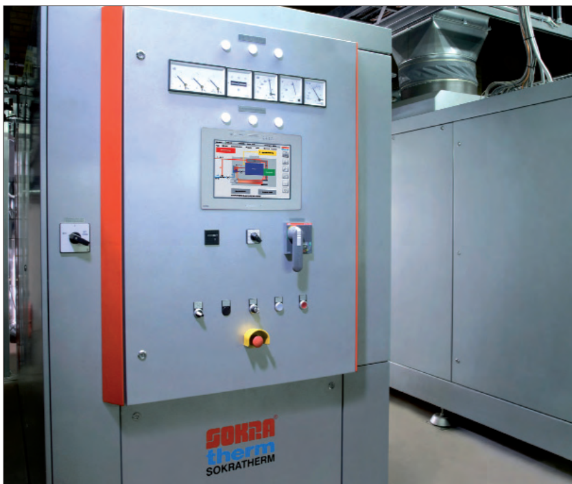
Bild 3. BHKW-Kompaktmodul GG 402 S mit neuer iPC-Steuerung
