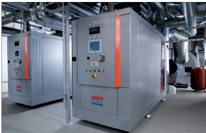
Bild 2. Doppelanlage: zwei BHKW-Kompaktmodule GG 237 S
