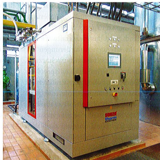
Das neue BHKW-Kompaktmodul von Sokratherm in der medius Klinik Kirchheim unter Teck.
