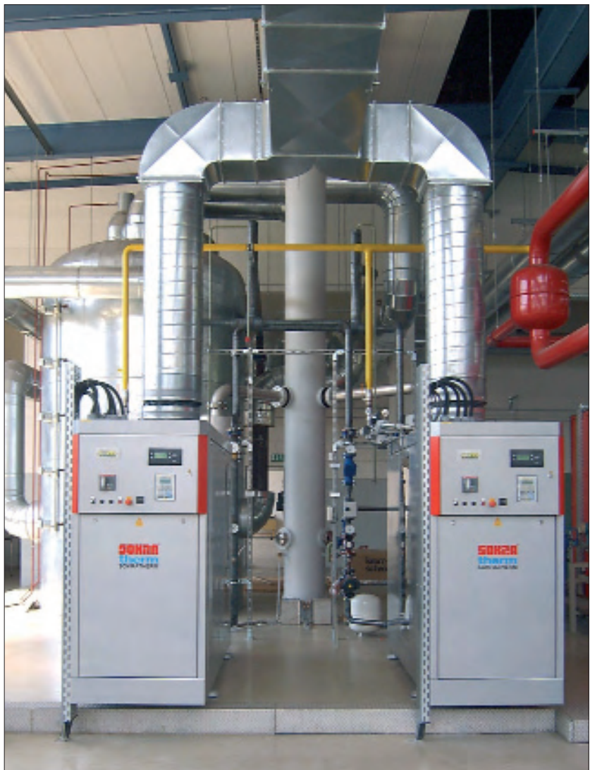
Bild 1. Die installierte Anlage mit MaxiManager-Schaltschrank zur Steuerung der Gesamtanlage
