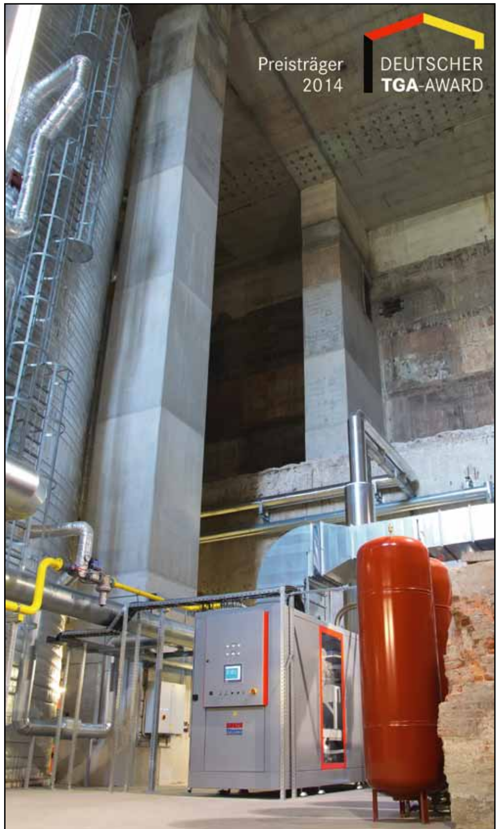
Bild 2. Innenansicht des Energiebunkers mit 2000 m 3 Wärmespeicher (links), BHKW-Kompaktmodul GG 530 mit 532 kW elektrischer und 686 kW thermischer Leistung (Mitte) und Expansionsbehältern (rechts). Der Energiebunker ist Teil des Klimaschutzprojekts »Erneuerbares Wilhelmsburg«: Ziel dieses von der EU geförderten Projekts ist die Versorgung der Elbinseln mit ausschließlich erneuerbarem Strom bis zum Jahr 2025, die komplette Wärmedeckung aus erneuerbaren Energien ist bis 2050 geplant.
