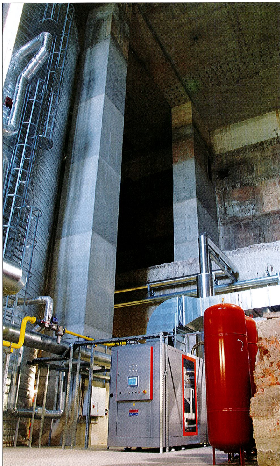
Bild 2. Innenansicht des Energiebunkers: Ein Biomethan-Blockheizkraftwerk mit 532 kW elektrischer und 686 kW thermischer Leistung sowie ein Wärmespeicher mit 2000 m 3 und Expansionsbehälter versorgen den Hamburger Stadtteil Wilhelmsburg mit erneuerbarem Strom und Wärme; der Energiebunker ist Teil des Klimaschutzprojekts »Erneuerbares Wilhelmsburg«: Ziel dieses von der EU geförderten Projekts ist die Versorgung der Elbinseln mit ausschließlich erneuerbarem Strom bis zum Jahr 2025, die komplette Wärmedeckung aus erneuerbaren Energien ist bis 2050 geplant
