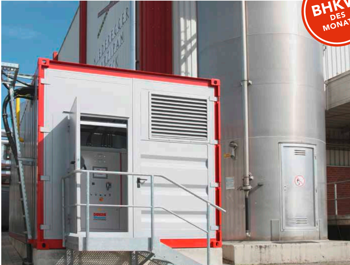
Neue Energieversorgung für Niederegger: kompakt im Container
