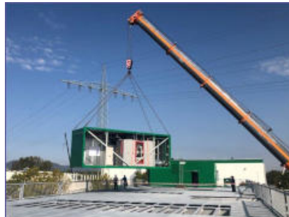
2 BHKW-Kompaktmodule GG 530 H mit SCR-Katalysator, APL Landau
