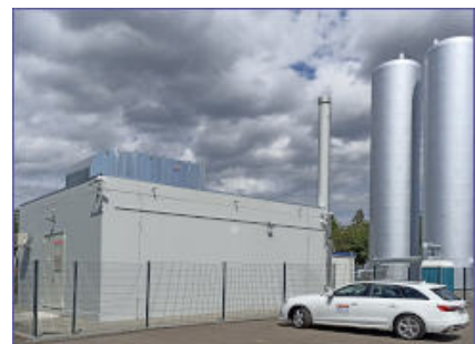
Blockheizkraftwerk GG 1000 Nahwärmeversorgung Kitzscher
