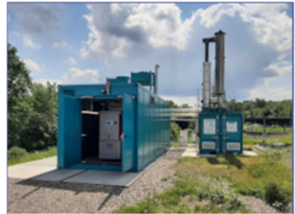
BHKW-Kompaktmodul FG 95 Deponie Reesberg, Kirchlengern
