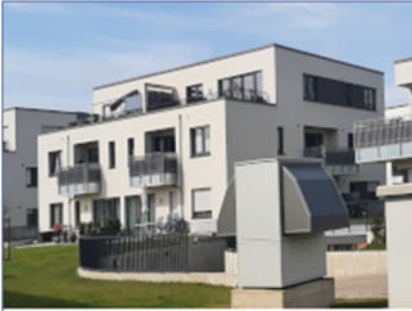
BHKW-Kompaktmodul GG 50 6VRSB mit Luft-Wasser Wärmepumpe Wohnquartier am Uhlenbach, Herford
