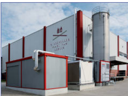
BHKW-Kompaktmodul GG 402 H mit Heizkühlung, im Container aufgestellt J.G. NIEDEREGGER GmbH & Co. KG, Lübeck
