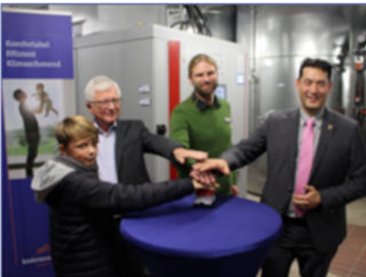
BHKW-Kompaktmodul GG 260 Heizkraftwerk Seidenfäden, Denzlingen
