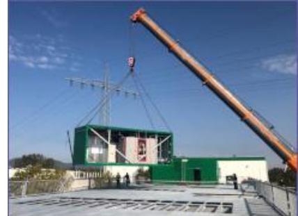
2 BHKW-Kompaktmodule GG 530 H mit SCR-Katalysator, APL Landau
