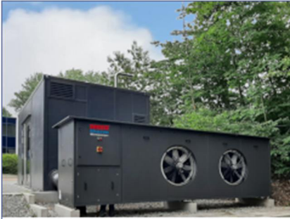
BHKW-Kompaktmodul GG 50 6VRSB P Luft-Wasser Wärmepumpe 75 kWth Nahwärmenetz und Stammsitz Hiddenhausen
