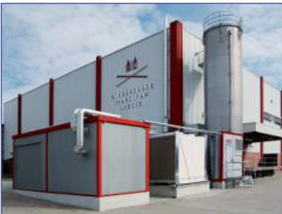
BHKW-Kompaktmodul GG 402 H mit Heizkühlung, im Container aufgestellt J.G. NIEDEREGGER GmbH & Co. KG, Lübeck
