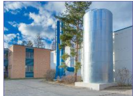
BHKW-Kompaktmodul GG 237 mit Ersatzstromfunktion VEM Motors GmbH, Wernigerode
