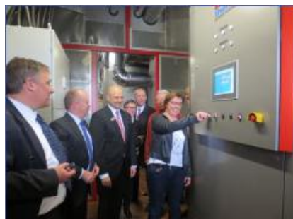
BHKW-Kompaktmodul GG 530 mit zusätzlicher Einhausung Thiebauthschule Ettlingen
