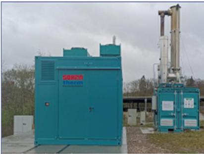
BHKW-Kompaktmodul FG 95 Deponie Reesberg, Kirchlegern
