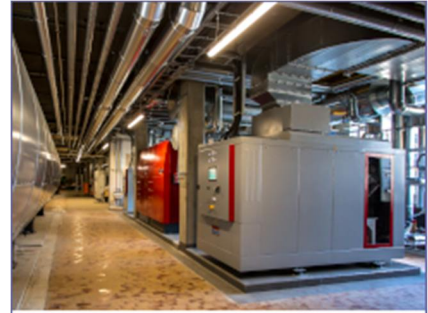
BHKW-Kompaktmodul GG 260 H BHKW-Kompaktmodul GG 100 H Schul- und Verwaltungszentrum Ravensburg
