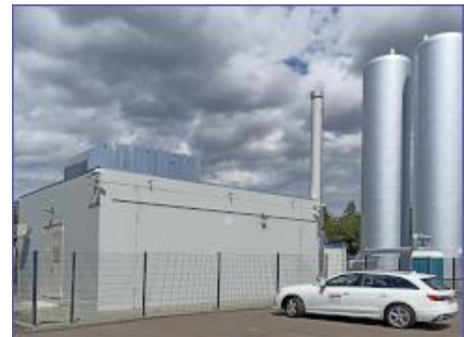
Blockheizkraftwerk GG 1000 Nahwärmeversorgung Kitzscher
