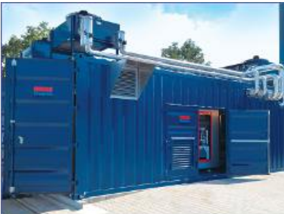
2 BHKW-Kompaktmodule FG 250 Kläranlage Herford
