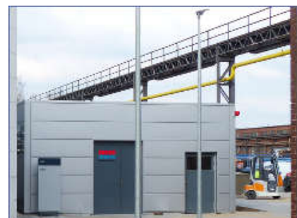
BHKW-Kompaktmodul GG 260 Demonstrationsanlage mit Feldversuchsmotor MAN Bus & Truck AG, Motorenwerk Nürnberg
