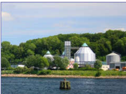
3 BHKW-Kompaktmodule FG 250 Kläranwerk Kielseng, Flensburg
