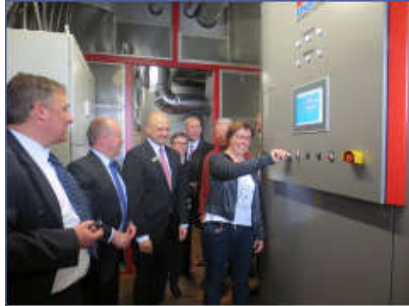
BHKW-Kompaktmodul GG 530 mit zusätzlicher Einhausung Thiebautschule Ettlingen
