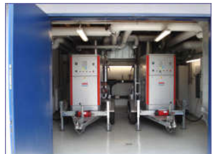
2 BHKW-Kompaktmodule GG 50 mobil Freibad Enkenbach (Foto) im Sommerbetrieb Grundschule und Bürgerhaus im Winterbetrieb
