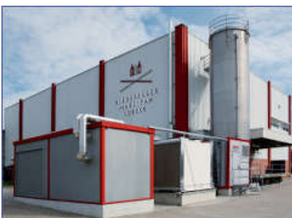
BHKW-Kompaktmodul GG 402 H mit Heißkühlung, im Container aufgestellt J.G. NIEDEREGGER GmbH & Co. KG, Lübeck
