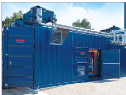
2 BHKW-Kompaktmodule FG 250 Kläranlage Herford
