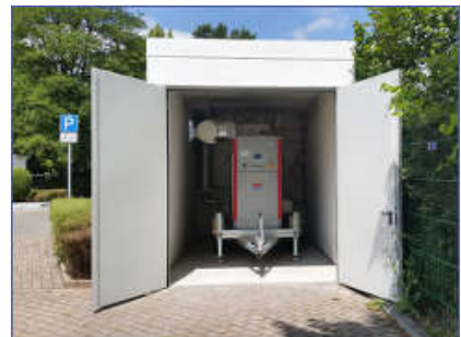
BHKW-Kompaktmodul GG 50 mobil Freibad und Schule Waldmohr
