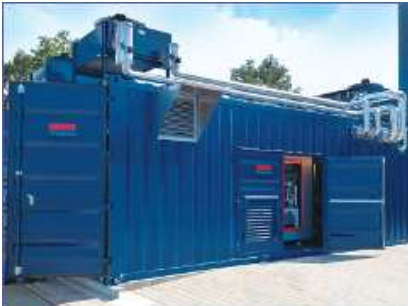
2 BHKW-Kompaktmodule FG 250 Kläranlage Herford
