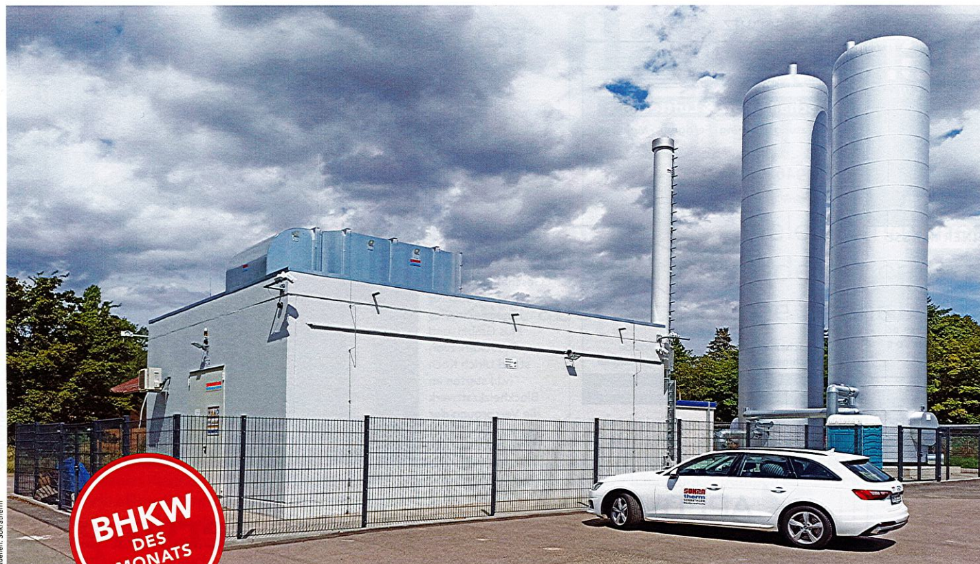
BHKW-Einhausung mit dem Wärmespeicher in Kitzscher
