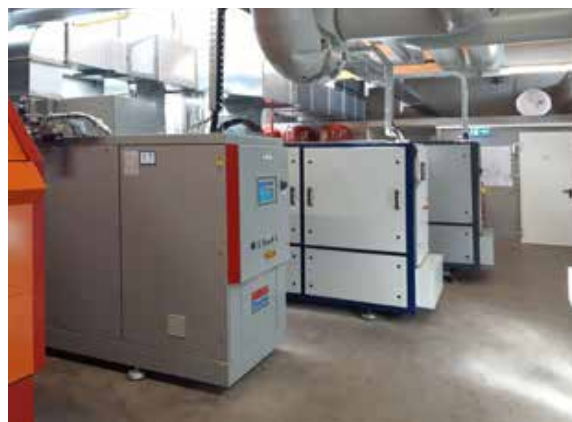
Das BHKW-Kompaktmodul von Sokratherm in der Energiezentrale des Schulzentrums Tiengen.
