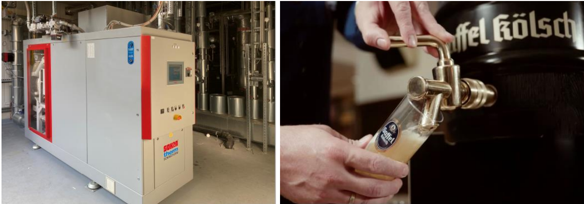
Bild 1: BHKW-Kompaktmodul Typ GG 132 H bei Gaffel und Zapfanlage. Quelle: Privatbrauerei Gaffel Becker & Co. OHG
