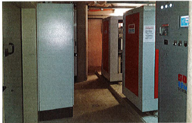
Die beiden BHKW-Module GG 110 IS (hinten im Bild) und das GG 140 (vorne rechts im Bild).
