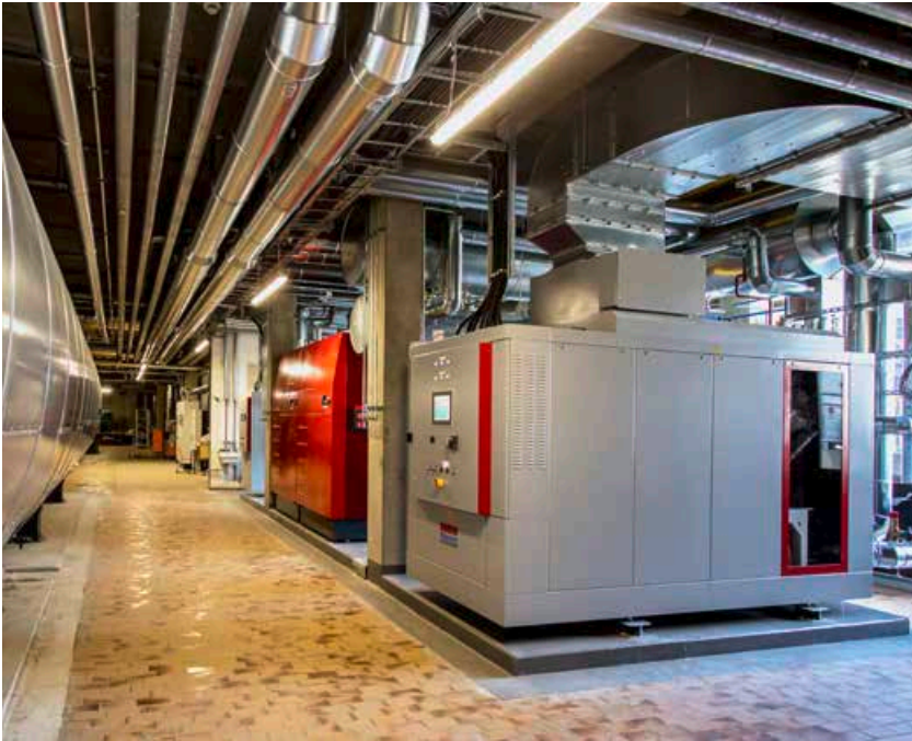
Die Energiezentrale mit zwei BHKW-Modulen und Wärmespeicher im Schul- und Verwaltungsquartier Ravensburg
