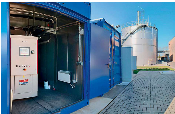
Gruppenklärwerk in Barsinghausen.
