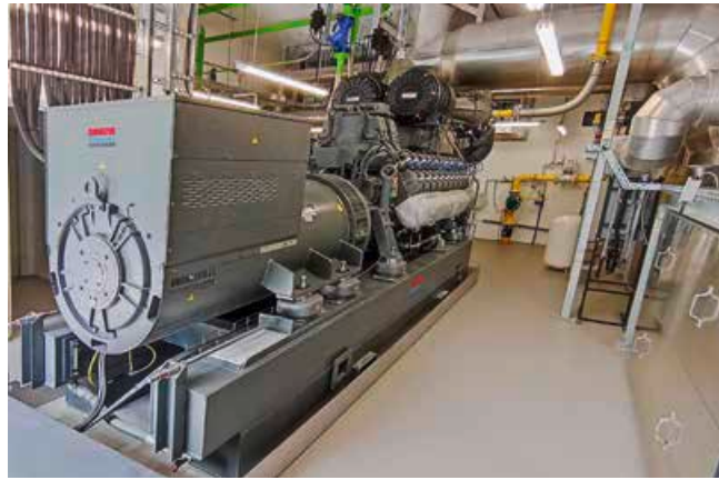
Das BHKW GG 1000 von Sokratherm mit SCR-Katalysator in Kitzscher
