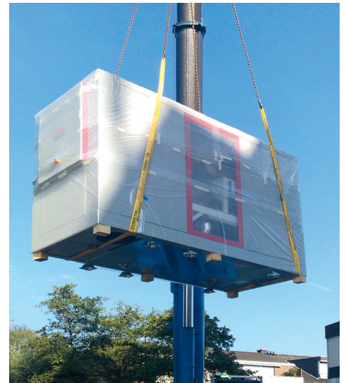
BHKW-Modul zur Versorgung der Wohnsiedlung in Oberhausen-Barmingholten.
