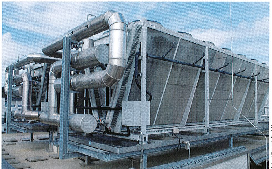
Rückkühler; Fabrikat: Güntner GmbH &amp; Co. KG
