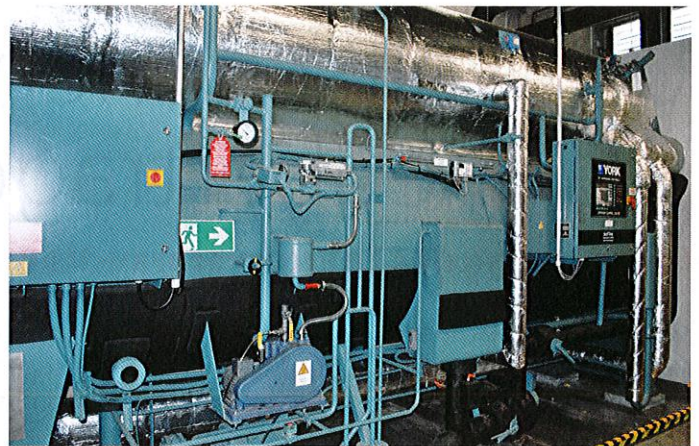
Absorptionskälteerzeuger von Johnson Controls/York
