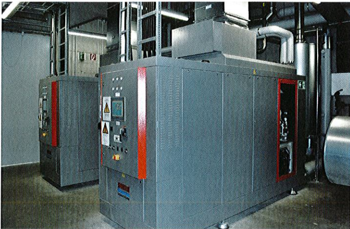
Blockheizkraftwerke von Sokratherm
