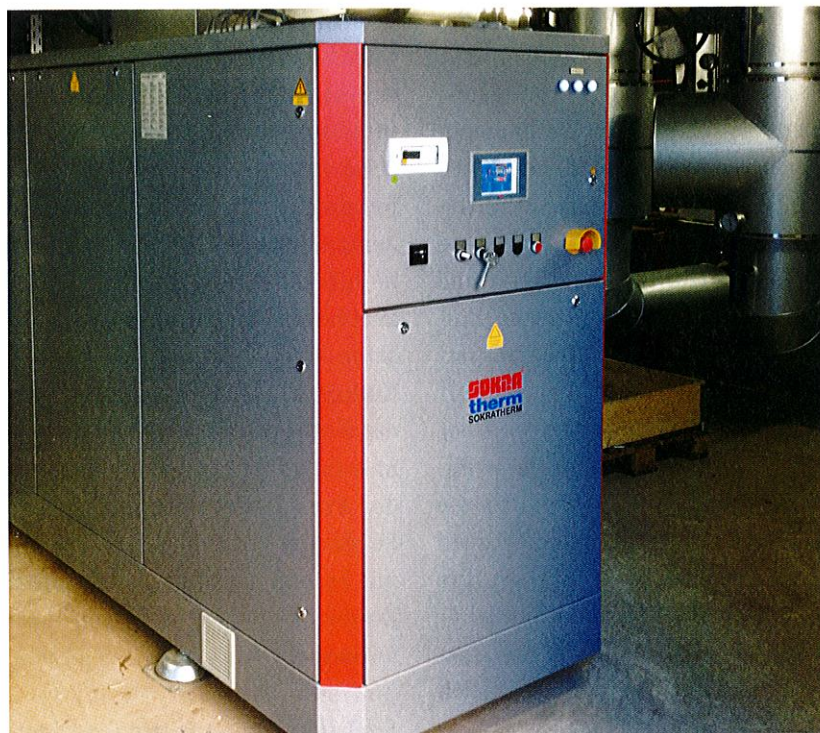
Das BHKW-Kompaktmodul GG 50 H in der Wärmeübergabestation an der Oderbrücke.
