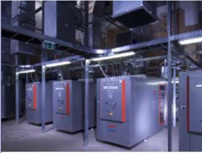
4 BHKW-Kompaktmodule GG 402 S Haldensleben, Fachklinik Haldensleben
