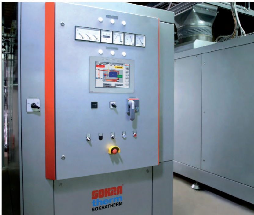
Bild 3. BHKW-Kompaktmodul GG 402 S mit neuer iPC-Steuerung
