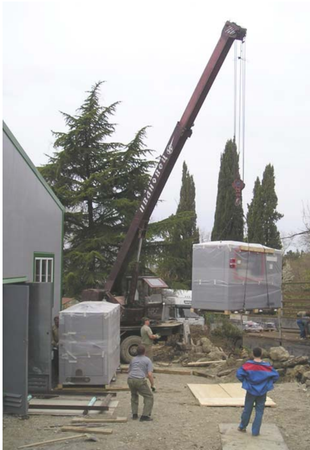
Abbildung 5: Ankunft des zweiten von drei BHKW-Kompaktmodulen GG 237 in Sotschi
